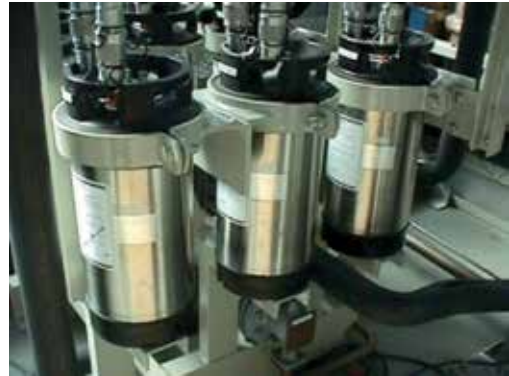
รูปที่ 20 Ion Exchanger
