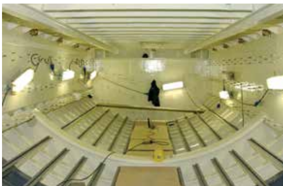
รูปที่ 2 ห้องเก็บแบตเตอรี่ของเรือดำน้ำก่อนบรรจุแบตเตอรี่
