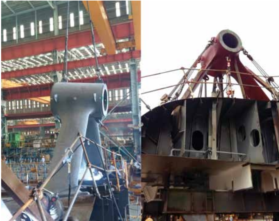
รูปที่ 4 การติดตั้ง Main Strut แบบชั่วคราว
