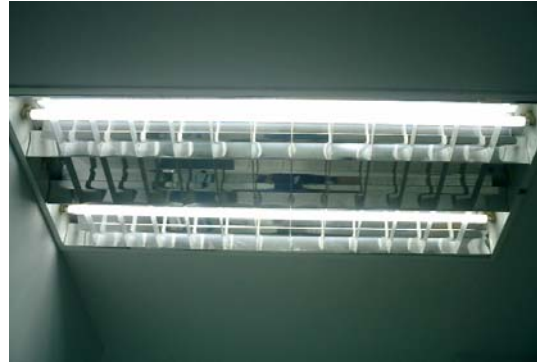
รูปที่ ๒ โคมไฟฟลูออโรหลอด ๓ หลอด เมื่อเปิดใช้ไฟฟ้า ๒ หลอด
